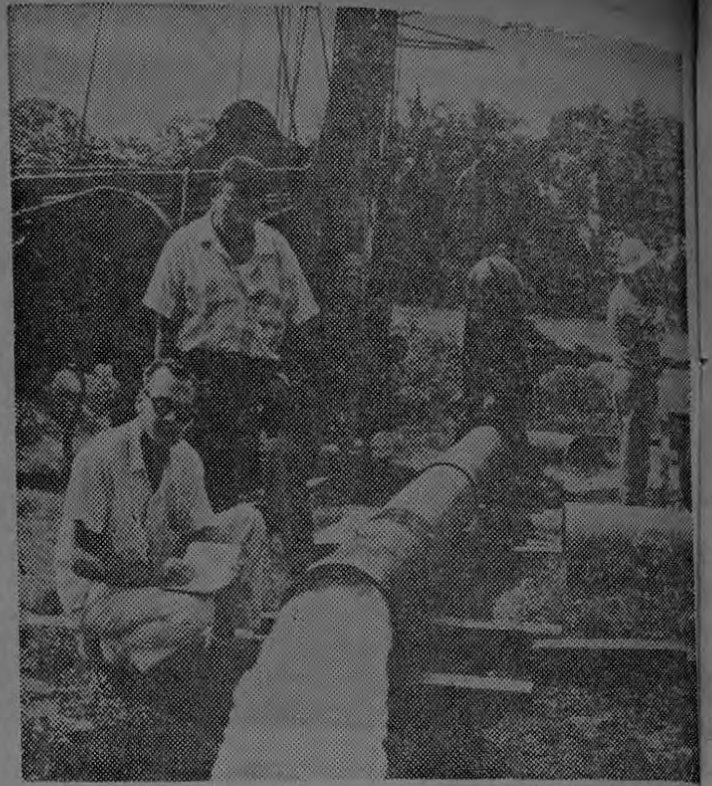
EL SALVADOR.—Aguas subterráneas localizadas por un grupo de técnicos salvadoreños y de la FAO.
